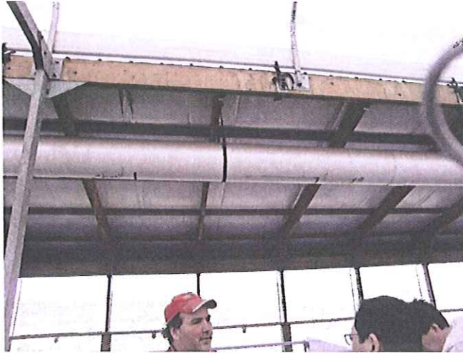
写真3 上部陽圧換気用のパイプ
